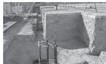
写真-2 高床形状タイプの物流倉庫工事における施工状況
